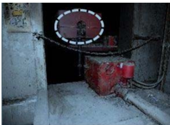
写真2-1. 放水銃 [No. 1] : 外観
