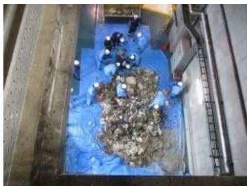
写真1-5. 調査作業 （作業中, 5階から撮影）
