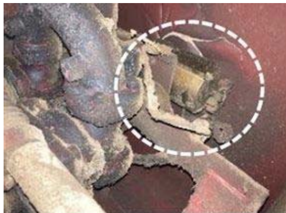
写真2-2. 放水銃 [No. 1] : 内部
