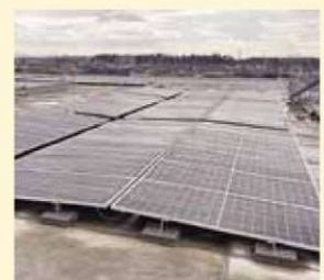
ゆいの杜小学校校舎の屋上に設置した太陽光パネル
