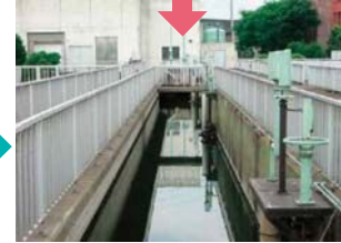
消毒設備 塩素という薬品を入れて消毒します。
