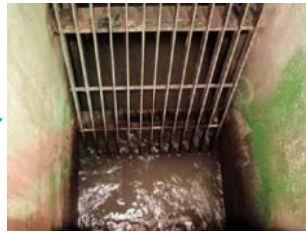
沈砂池 砂や大きなごみを取り除きます。
