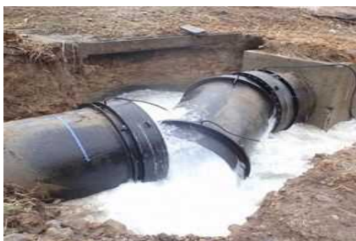
水道管の継手の破損（他市）
