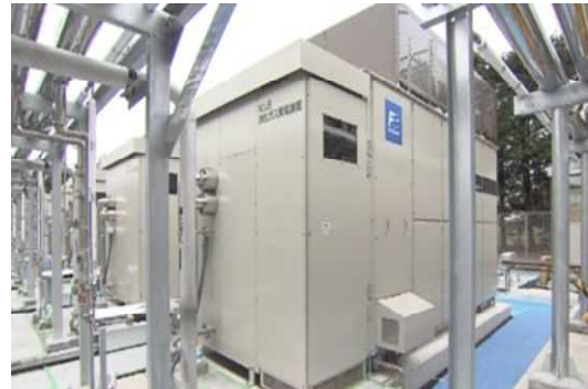
下水汚泥消化ガス ※14 発電施設（川田水再生センター）
