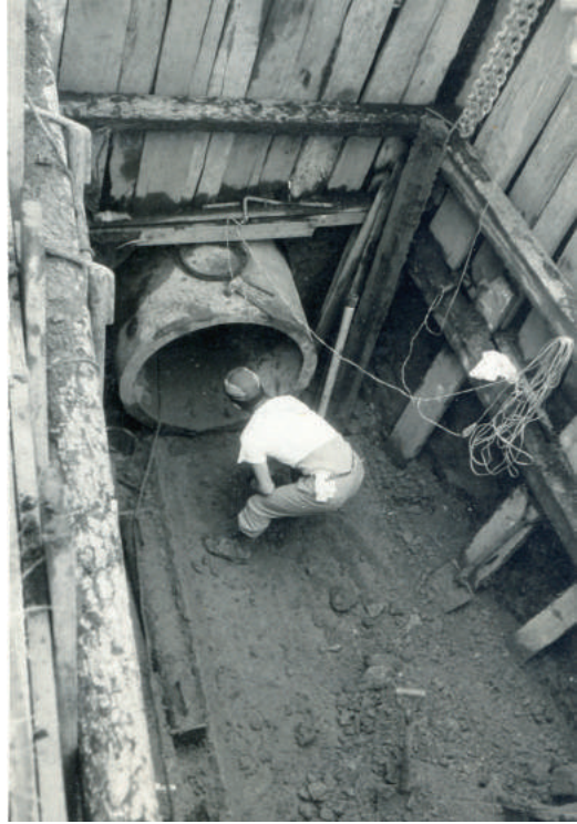
配水管布設工事 (昭和43年5月：河内町内、県道上阿久津宇都宮線)
