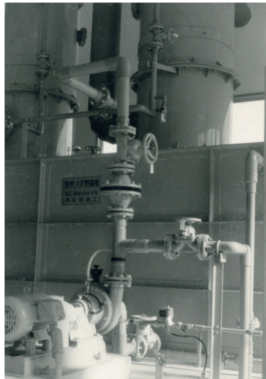
白沢水源地ポンプ室内(昭和44年2月)
