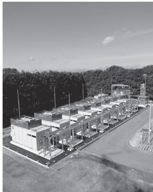
図S6-17 消化ガス発電施設(川田水再生センター)
