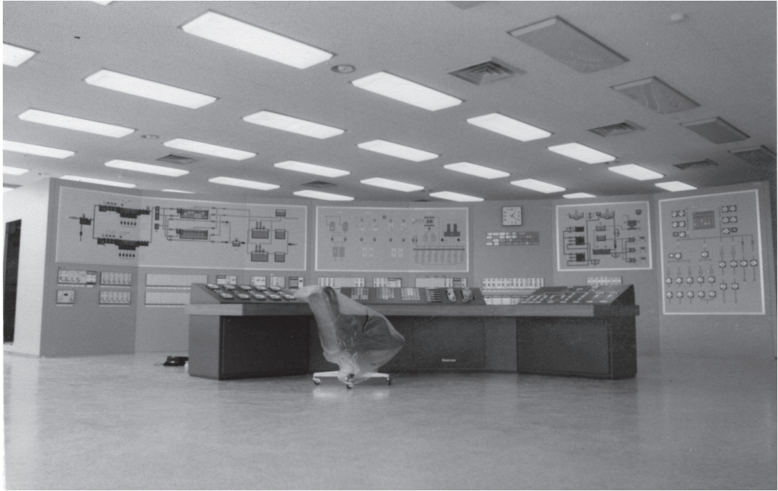
図6-6 中央管理本館3Fの中央管理室(松田新田浄水場)
